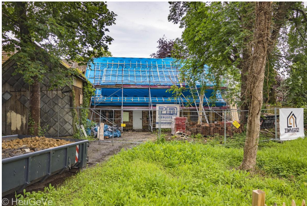
Frontansicht mit reparierter Vordergaube
