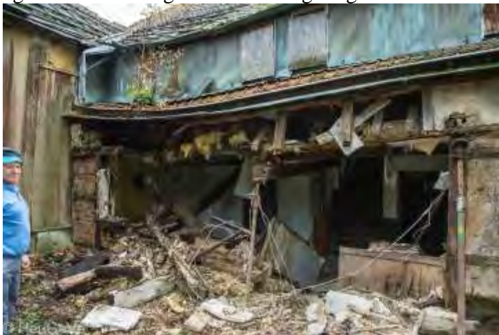
Die „linke Ecke“ des Denkmals mit den abgestützten Balken
