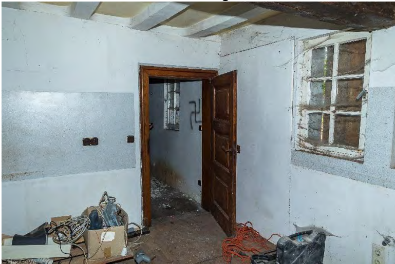
Im Bereich des Seiteneingangs scheinen Decken, Fußböden und Wände noch intakt. Aber schon hier erkennt man bereits eine starke Vermüllung.
