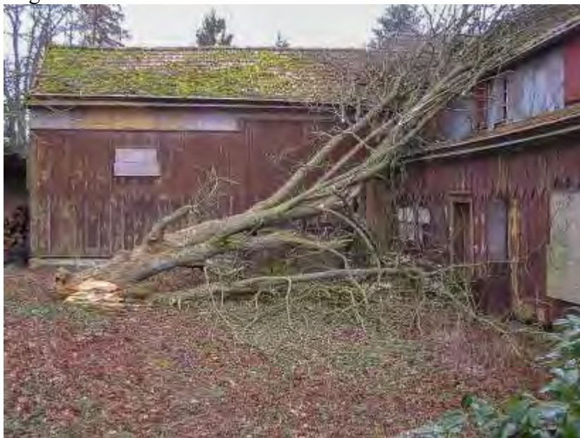
Dachschaden durch umgestürzten Baum, 2016
