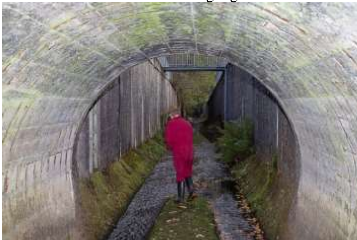
Das Auslaufbauwerk des Weserstollens
