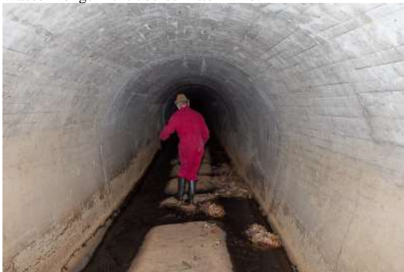
Gehweg im Stollen, darunter liegt die Abwasserleitung.
