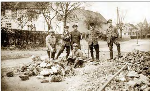
Die Reichsstraße 258 musste im Frühjahr 1929 wegen Frostschäden repariert werden. • HeGwA 22-97
